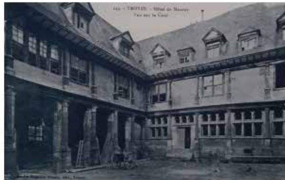
Photographie montrant la restauration de l'hôtel Mauroy vers 1852-1856 (prise de vue opposée à la photographie précédente).
